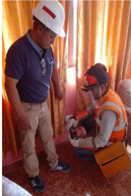
Registrador de tensión instalado en un tomacorriente del cliente
