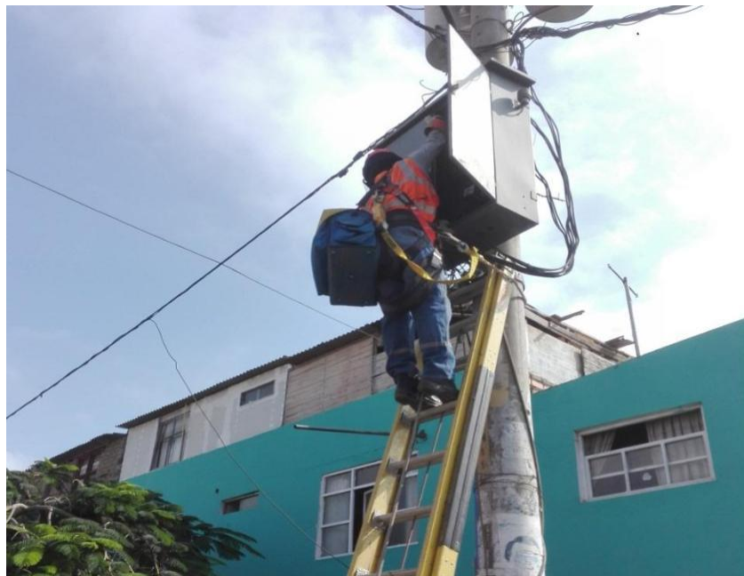
Aperturando el tablero de distribución SED-CH0011
