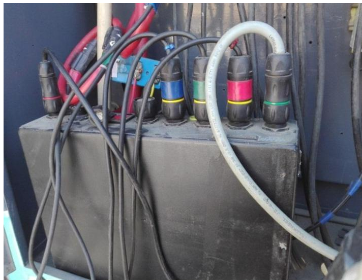
Analizador de redes instalado en el tablero de distribución SED-CH0011
