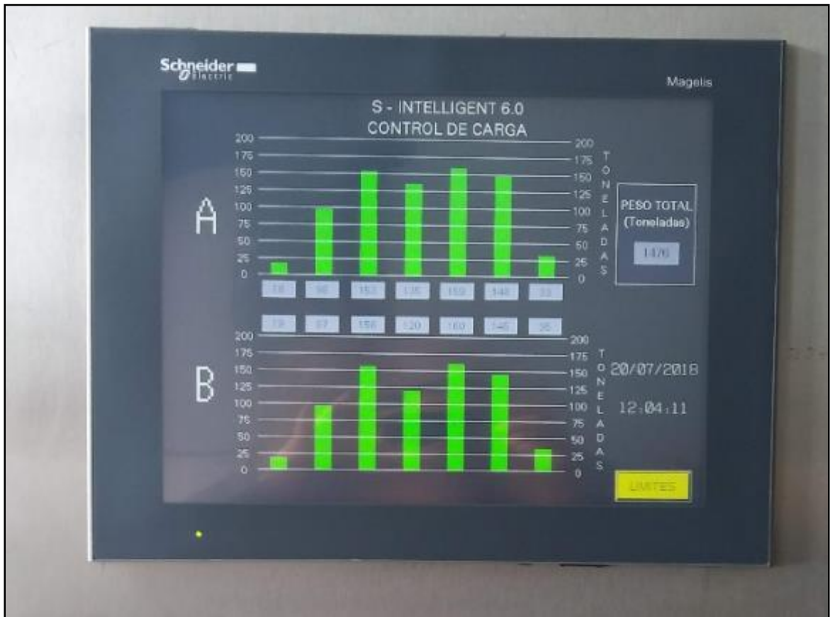
Figura 24. Panel de operador sistema de mando Fuente: (E. Propia)
