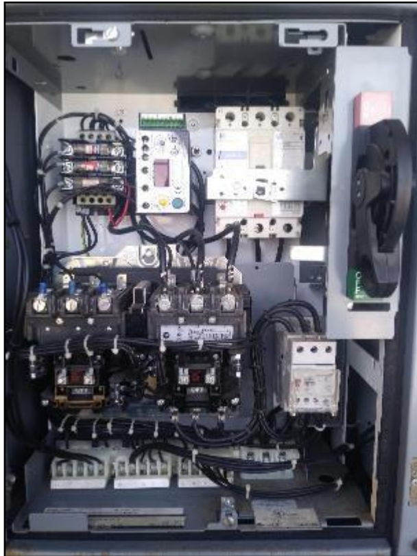
Figura 17. Control de motor por contactores
