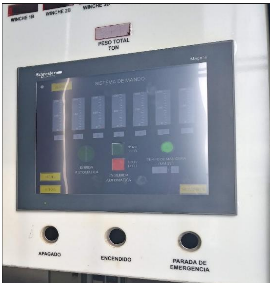
Figura 21. Panel de operador sistema de mando
