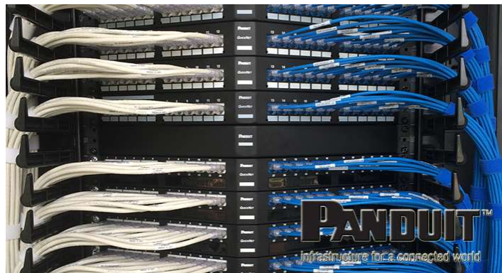
Figura N° 05. Administración de cables tipo PANDUIT
