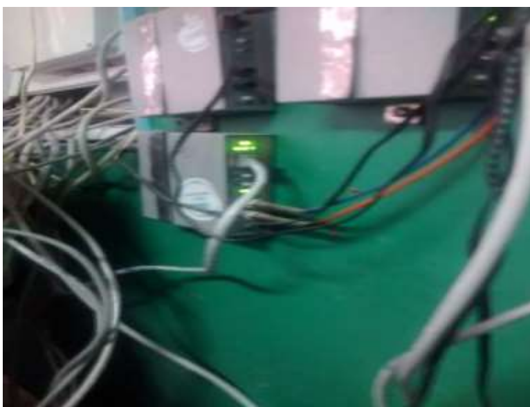
Cableado sin canaletas
