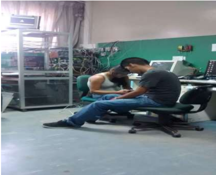
Cableado sin canaletas – riesgo para el personal
