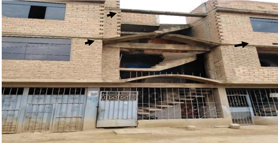
Figura 21 Deficiencia en los confinamientos de los elementos
