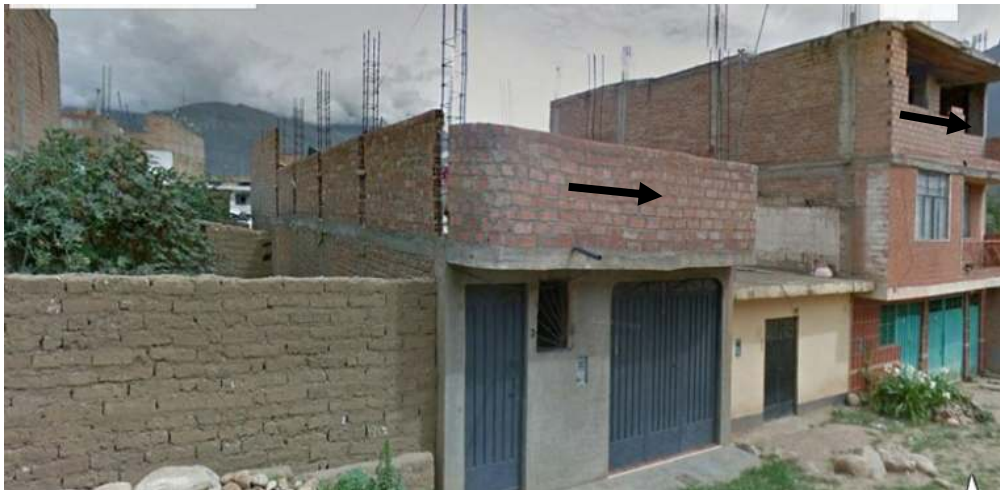
Figura 20 Muros inestables para la fuerza sísmica en esa dirección
