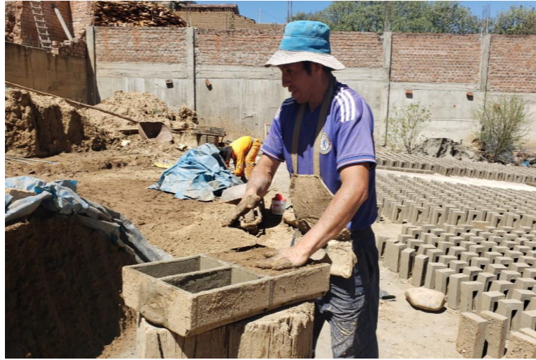
Figura 12: Proceso de elaboración de ladrillos (4) en moldes o gaveras de madera - ladrillera Santa Rosa – CPM San Nicolás - Huaraz
