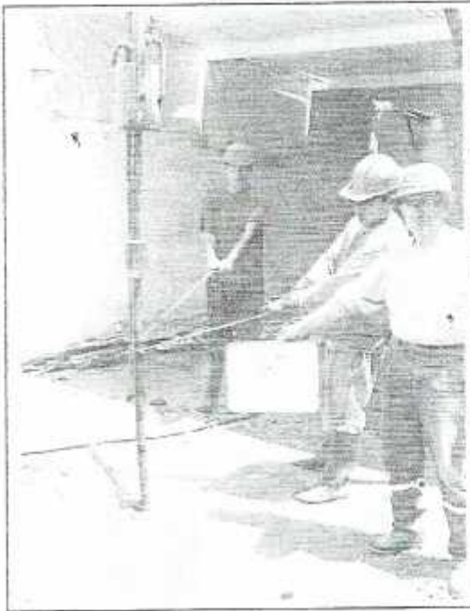
Foto N°03: Vista de ubicación del SPT-01, ensayo de resistencia a la penetración a los 5.00m de profundidad. Presencia de arena mal graduada con limos (SP-SM), compacto, satura de color beige oscuro.
