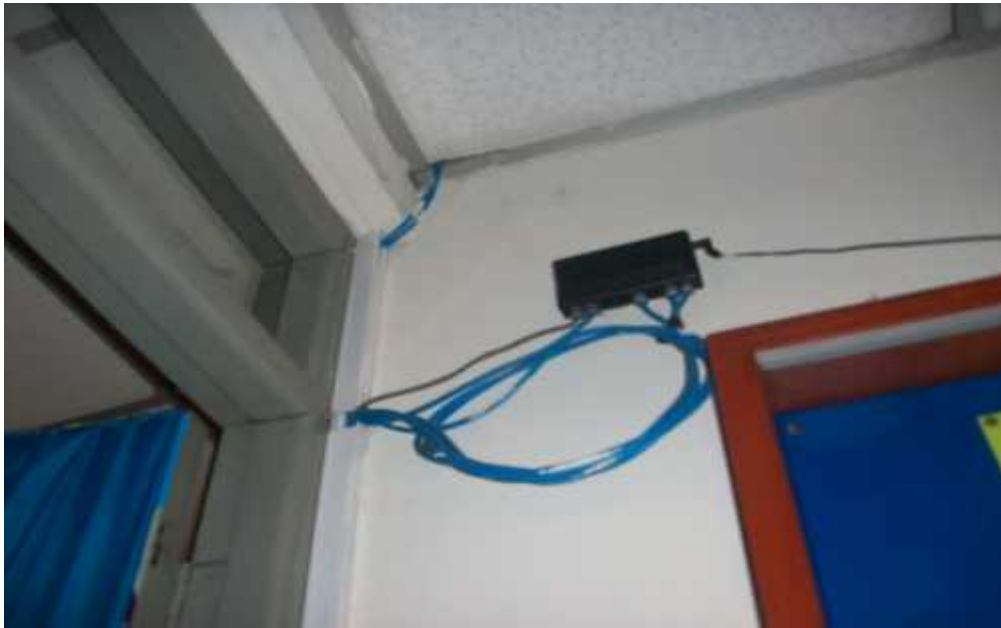
Cables expuestos de energía eléctrica
