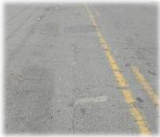
Fotografía N° 06 identificación de la falla: grieta parabólica o por deslizamiento – alta Severidad (PCI Desplazamiento o Abultamiento o Ahuellamiento de la mezcla, profundidad > 40mm (VIZIR)
