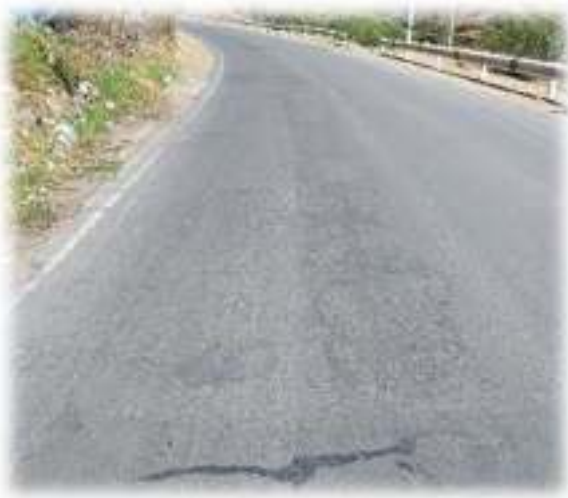
Fotografía N° 04 identificación de la falla: Desplazamiento – Media Severidad (PCI), Desplazamiento o Abultamiento o Ahuellamiento de la mezcla, profundidad 20mm – 40mm (VIZIR)
