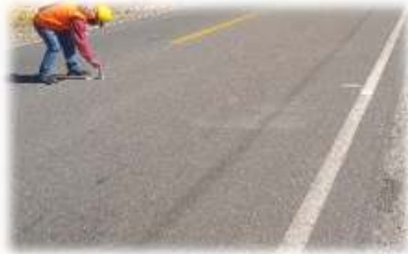
Fotografía N° 01 Señalización con pintura blanca de los límites de daño deteriorado
