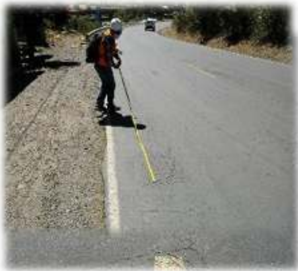
Fotografía N° 05 identificación de la falla: Piel de Cocodrilo – alta Severidad (PCI), Fisura de piel de cocodrilo, profundidad <200mm con pérdida de material (VIZIR)
