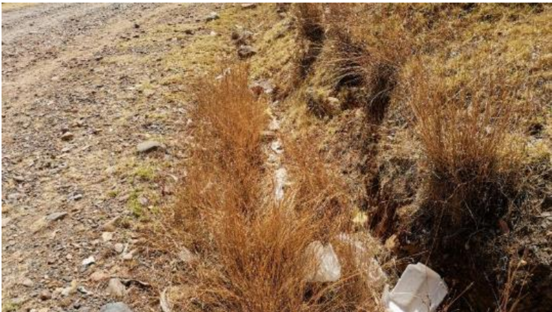
Figura 23: Falla 82 Drenaje inadecuado
