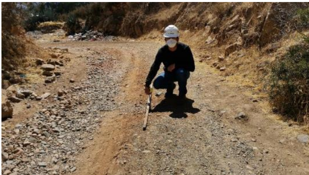
Figura 45: Unidad de muestra N°3 (prog. 1+320 km – 1+420 km). Falla 85 (Baches) según tabla 6 (Nivel B), de cantidad 18.
