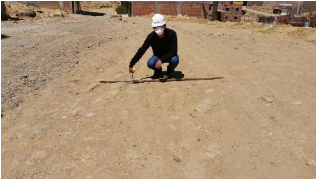
Figura 32: Unidad de muestra N°1 (prog. 0+030 km – 0+080 km). Falla 81 (Sección transversal incorrecta) según tabla 6 (Nivel B), con longitud 50 m.
