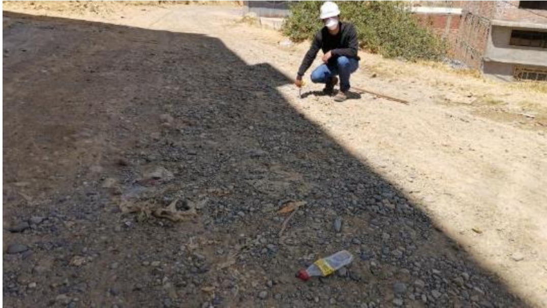
Figura 37: Unidad de muestra N°1 (prog. 0+030 km – 0+080 km). Falla 87 (Agregado Suelto) según tabla 6 (Nivel B), de longitud 40m.
