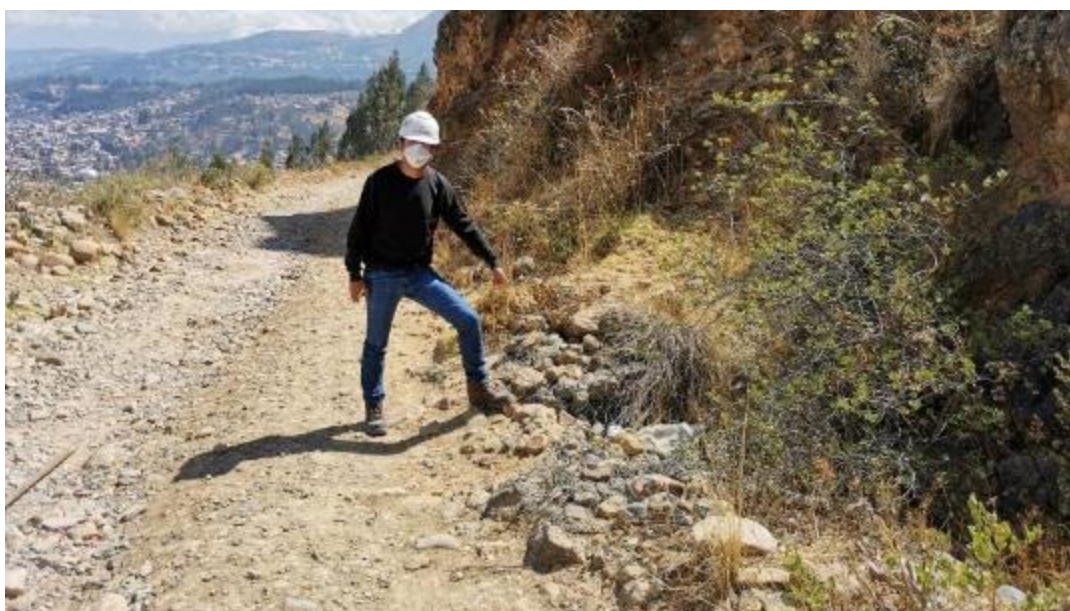
Figura 50: Unidad de muestra N°4 (prog. 1+630 km – 1+720 km). Falla 82 (Drenaje Inadecuado) según tabla 6 (Nivel A), de longitud 90m.
