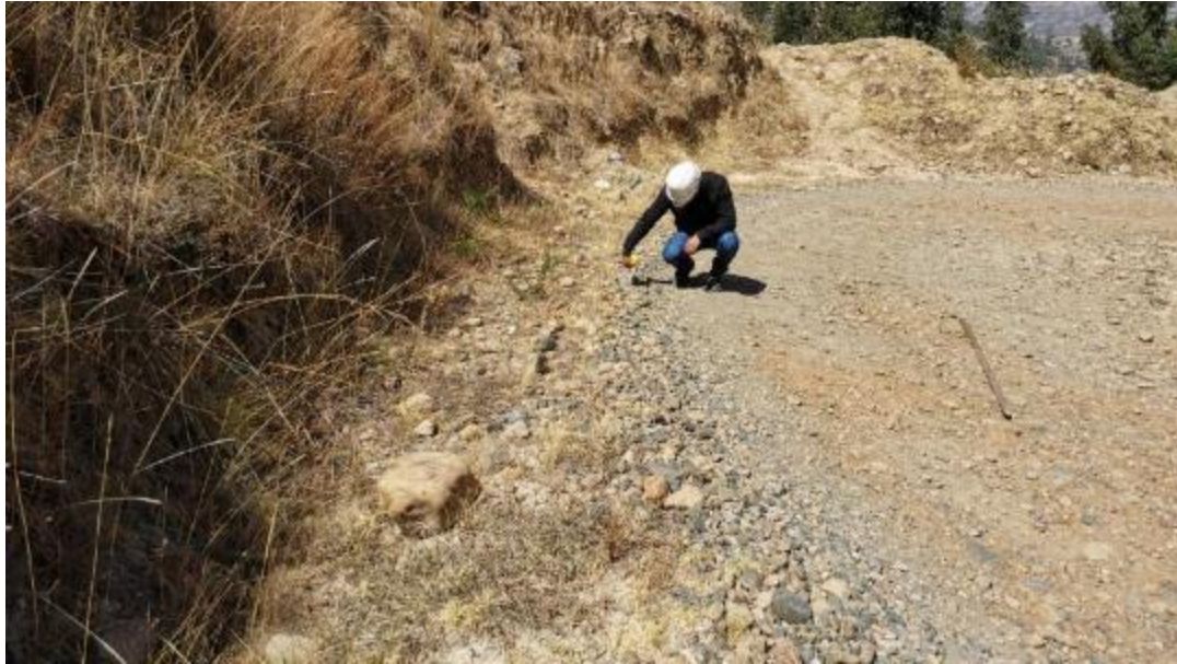
Figura 53: Unidad de muestra N°4 (prog. 1+630 km – 1+720 km). Falla 87 (Agregado Suelto) según tabla 6 (Nivel A), de longitud 150m.
