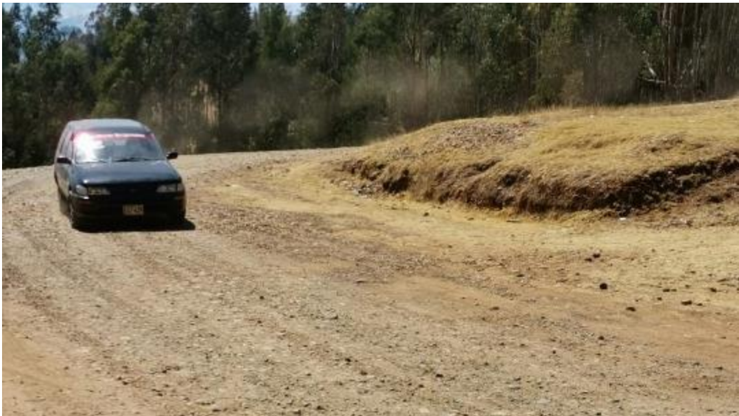
Figura 56: Unidad de muestra N°5 (prog. 2+030 km – 2+095 km). Falla 84 (Polvo) según tabla 6 (Nivel B), de puntuación 2.
