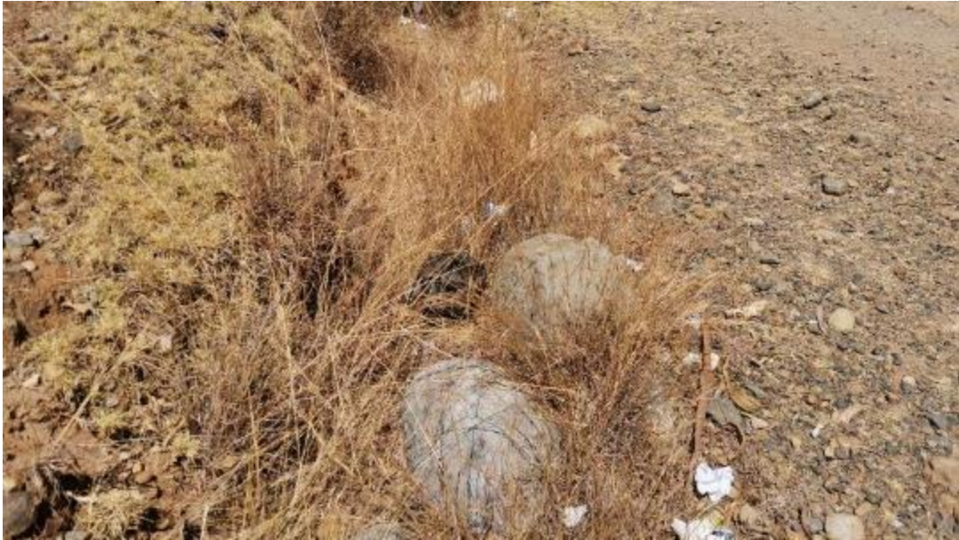
Figura 55: Unidad de muestra N°5 (prog. 2+030 km – 2+095 km). Falla 82 (Drenaje Inadecuado) según tabla 6 (Nivel A), de longitud 65m.
