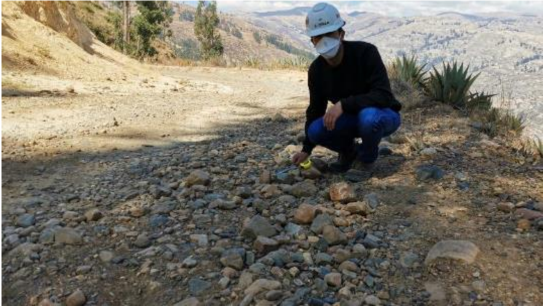
Figura 59: Unidad de muestra N°5 (prog. 2+030 km – 2+095 km). Falla 87 (Agregado Suelto) según tabla 6 (Nivel B), de longitud 120m.
