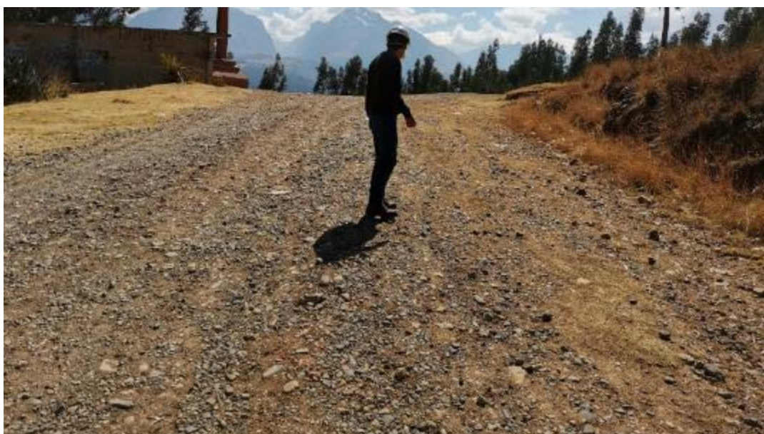
Figura 58: Unidad de muestra N°5 (prog. 2+030 km – 2+095 km). Falla 86 (Surcos) según tabla 6 (Nivel B), de área 33m 2 .
