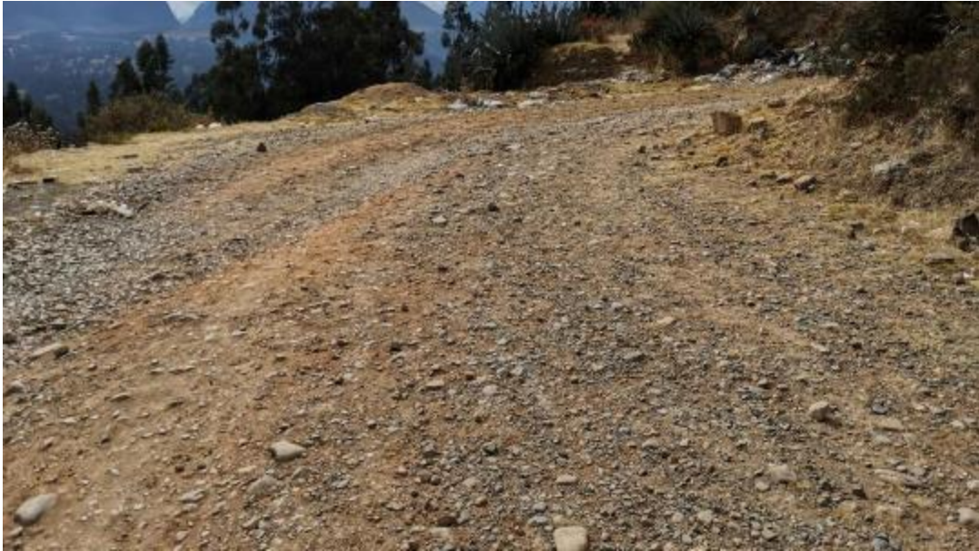
Figura 22: Falla 81 Sección transversal incorrecta
