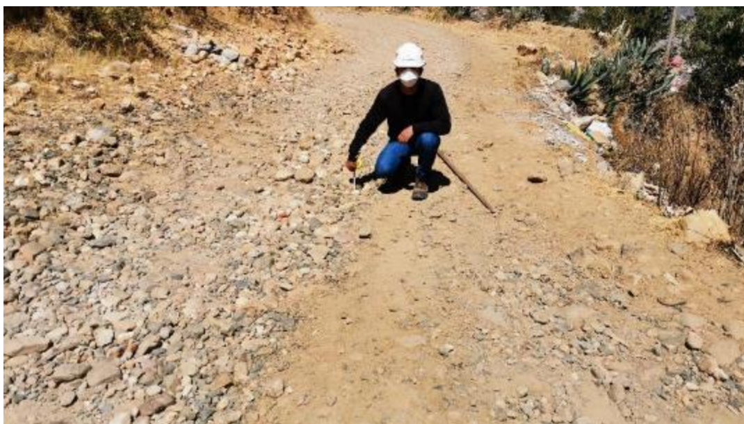
Figura 42: Unidad de muestra N°2 (prog. 0+550 km – 0+630 km). Falla 87 (Agregado Suelto) según tabla 6 (Nivel B), de longitud 160 m.
