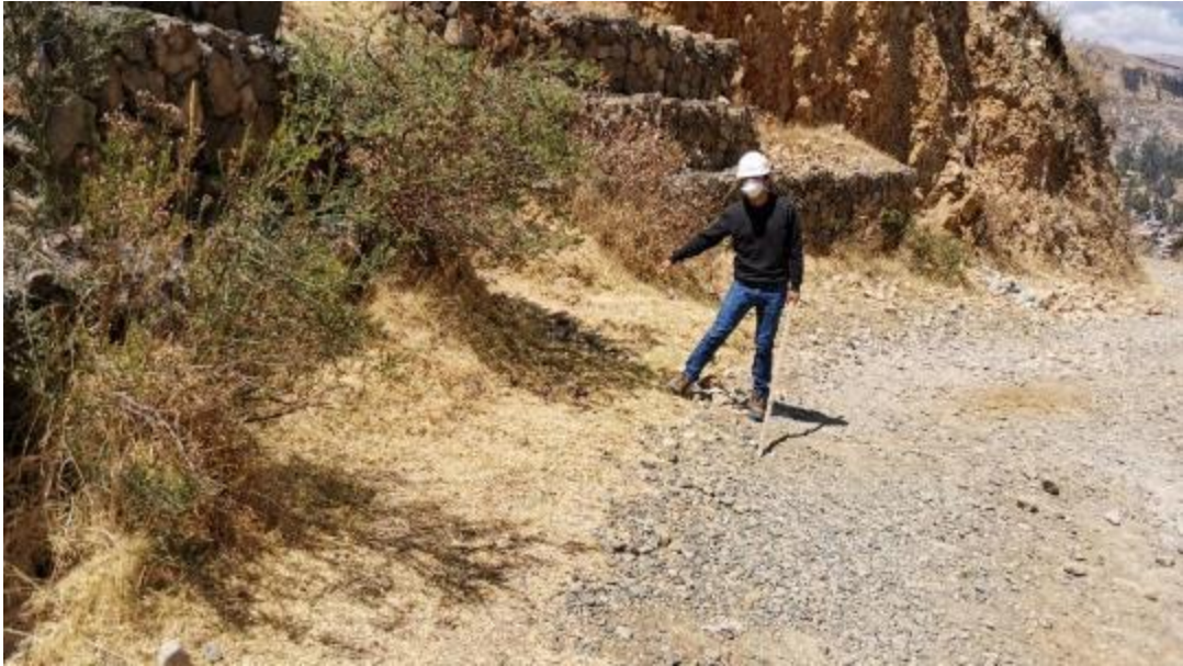
Figura 39: Unidad de muestra N°2 (prog. 0+550 km – 0+630 km). Falla 82 (Drenaje Inadecuado) según tabla 6 (Nivel A), de longitud 80m.
