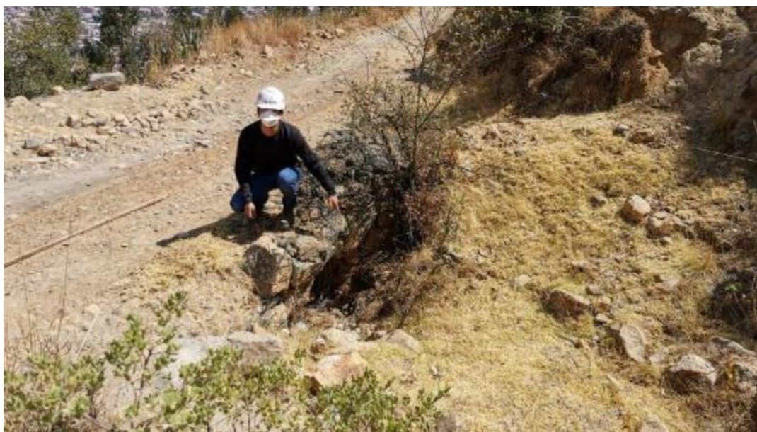
Figura 44: Unidad de muestra N°3 (prog. 1+320 km – 1+420 km). Falla 82 (Drenaje Inadecuado) según tabla 6 (Nivel A), de longitud 100 m.
