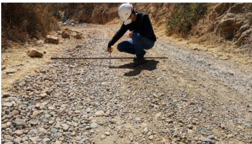
Figura 46: Unidad de muestra N°3 (prog. 1+320 km – 1+420 km). Falla 86 (Surcos) según tabla 6 (Nivel M), de área 36m 2 .
