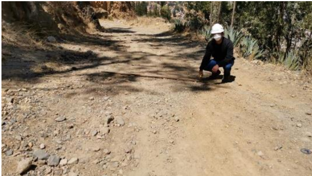
Figura 38: Unidad de muestra N°2 (prog. 0+550 km – 0+630 km). Falla 81 (Sección Transversal Incorrecta) según tabla 6 (Nivel B), de longitud 80m.
