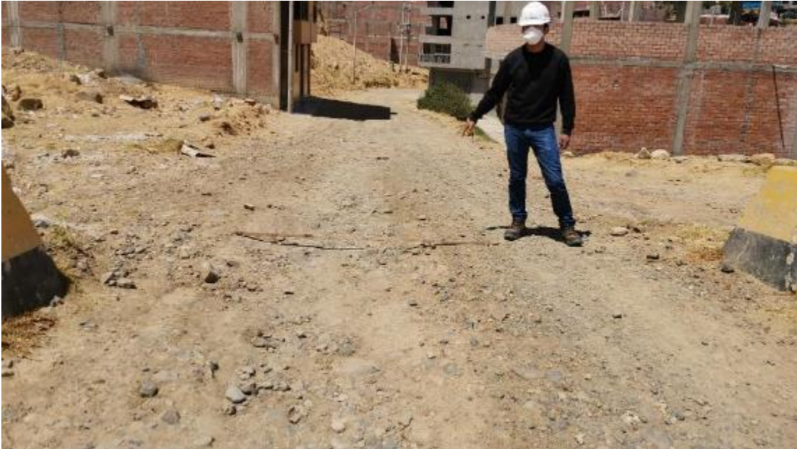
Figura 35: Unidad de muestra N°1 (prog. 0+030 km – 0+080 km). Falla 85 (Baches) según tabla 6 (Nivel B), de cantidad 25.
