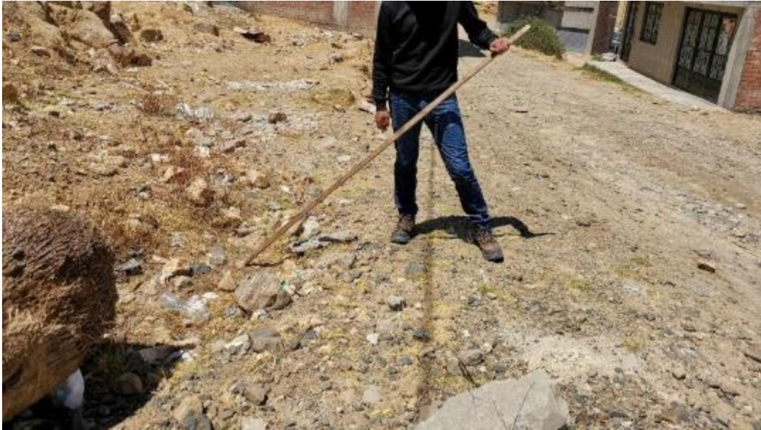
Figura 33: Unidad de muestra N°1 (prog. 0+030 km – 0+080 km). Falla 82 (Drenaje inadecuado) según tabla 6 (Nivel A), con longitud 50 m.
