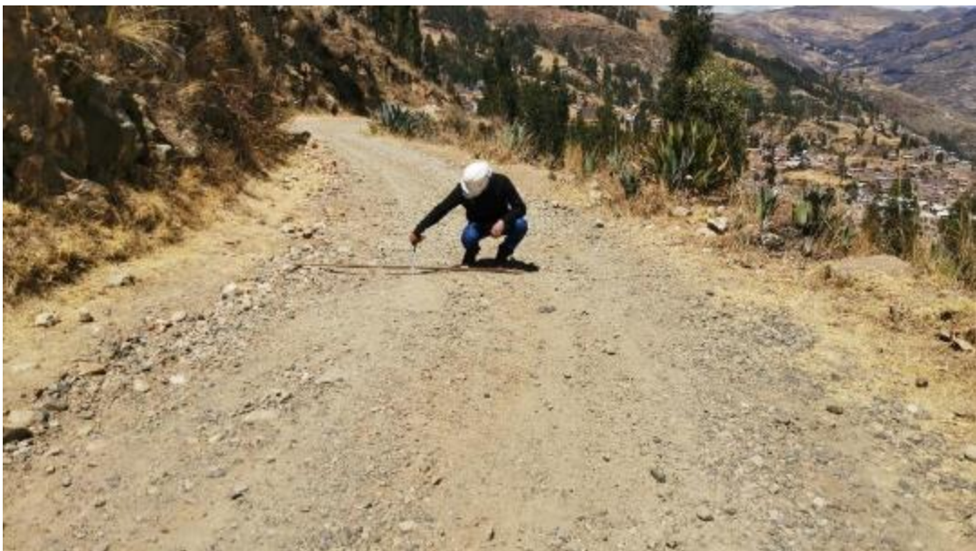
Figura 40: Unidad de muestra N°2 (prog. 0+550 km – 0+630 km). Falla 85 (Baches) según tabla 6 (Nivel B), de cantidad 27.
