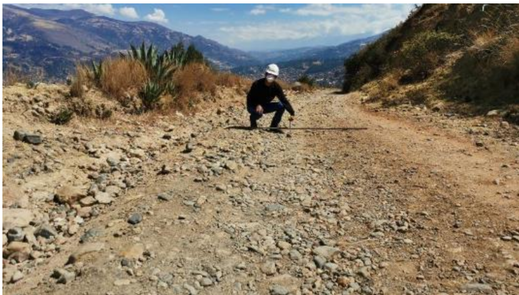
Figura 49: Unidad de muestra N°4 (prog. 1+630 km – 1+720 km). Falla 81 (Sección Transversal Incorrecta) según tabla 6 (Nivel B), de longitud 75m.
