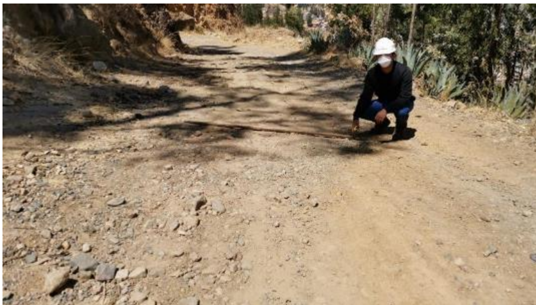
Figura 43: Unidad de muestra N°3 (prog. 1+320 km – 1+420 km). Falla 81 (Sección Transversal Incorrecta) según tabla 6 (Nivel M), de longitud 86 m.
