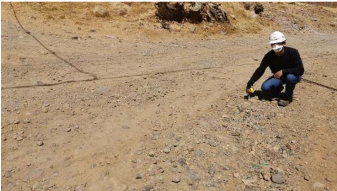
Figura 36: Unidad de muestra N°1 (prog. 0+030 km – 0+080 km). Falla 86 (Surcos) según tabla 6 (Nivel M), de área 20m 2 .
