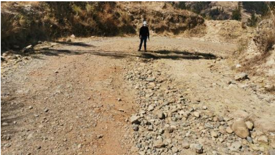
Figura 52: Unidad de muestra N°4 (prog. 1+630 km – 1+720 km). Falla 86 (Surcos) según tabla 6 (Nivel A), de área 36m 2 .
