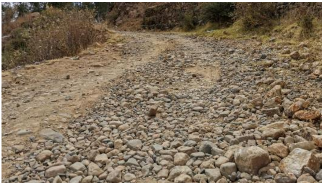
Figura 28: Falla 87 Agregado suelto
