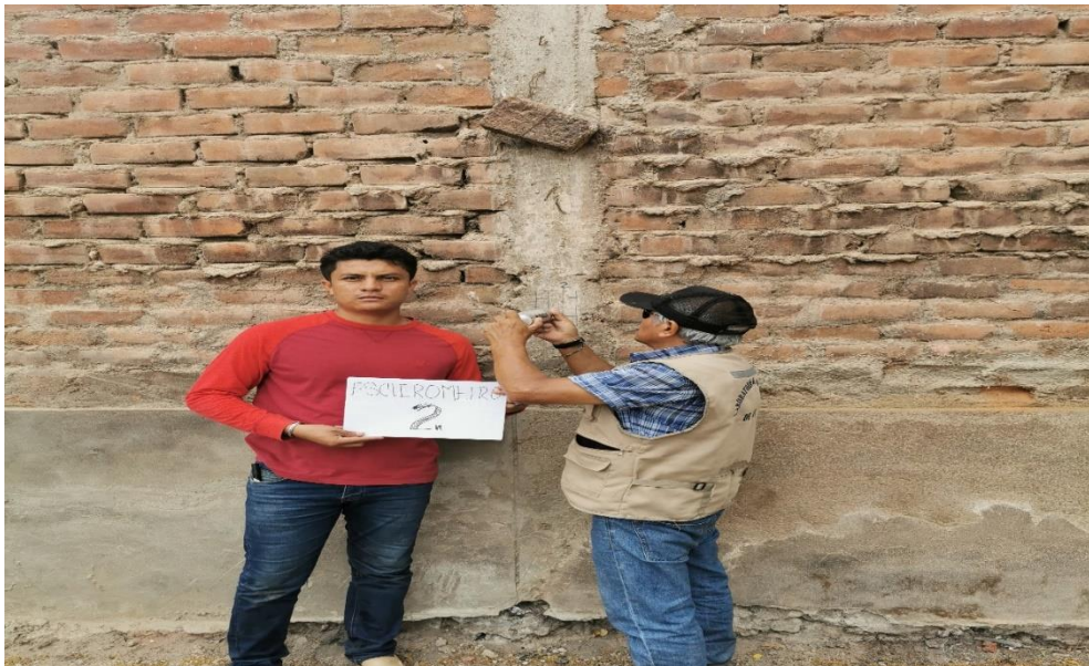
Foto 6: Prueba de esclerometría N°02 de concreto en columnas del cerco perimétrico de la Institución Educativa Ignacio Escudero, Sullana.
