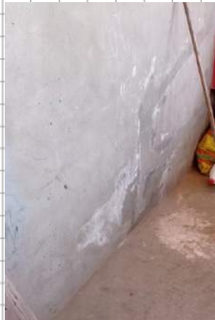
Eflorescencia presente en cimientos y sobrecimientos de muros.
