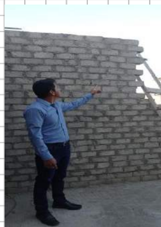
Muros sin confinamiento con peligro de volcadura.
