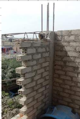
acero de vigueta y columna expuestos y corroidos, muro sin confinamiento.
