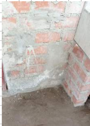
Eflorescencia presente en cimientos y sobrecimientos de muros portantes.
