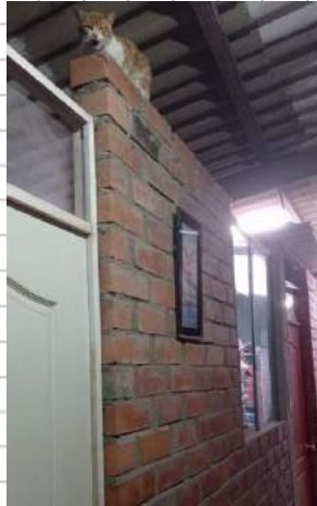
Muros y dinteles de puertas y ventanas sin confinar con peligro de volcadura de muros.
