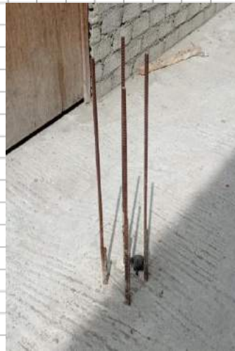
Mechas de columnas expuestas y corroidas.
