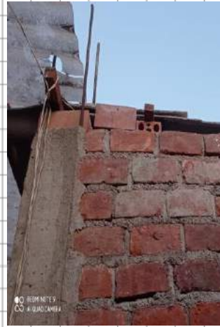
Mechas de columnas corroidas, muro sin confinamiento.
