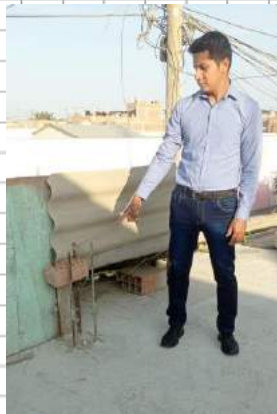
Mechas de columnas expuestas al ambiente, presenta corrosion.
