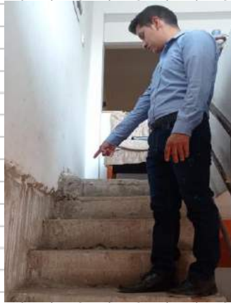
Seccion de viga solera de muro portante cortada por la mitad, acero corroido.
