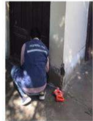
Podemos apreciar como la columna está deteriorada debido a la humedad y a la amigredad de la vivienda
