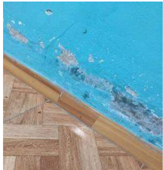
Salitre en Muros.
