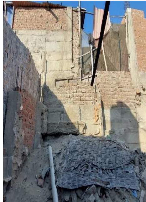
FOTO N° 38: Fallas de la vivienda ubicada en Jr. Magallanes Mz. N Lt. 12, entre ellas discontinuidad de muro, materiales de mala calidad.
