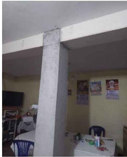
FOTO N° 23: Evaluación de los elementos estructurales la vivienda ubicada en Jr. Los Ángeles Mz. K Lt. 3
