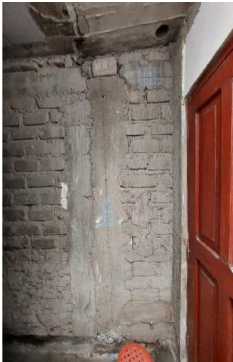
FOTO N° 42: discontinuidad en columna, juntas mayores a 1.5 cm y eflorescencia de salitre en la vivienda ubicada en Jr. Brasil Mz. Ñ Lt. 20
