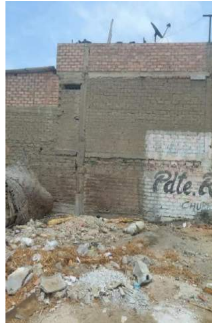
FOTO N° 41: Fallas de la vivienda ubicada en Jr. Brasil Mz. Ñ Lt. 20, entre ellas materiales de mala calidad, desmoronamiento de concreto
