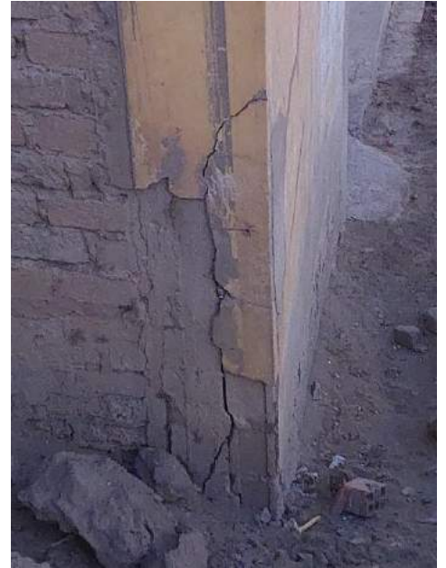
FOTO N° 21: Falla de la vivienda ubicada en Jr. Áncash Mz. F Lt. 26, donde se evidencia agrietamiento en la columna
