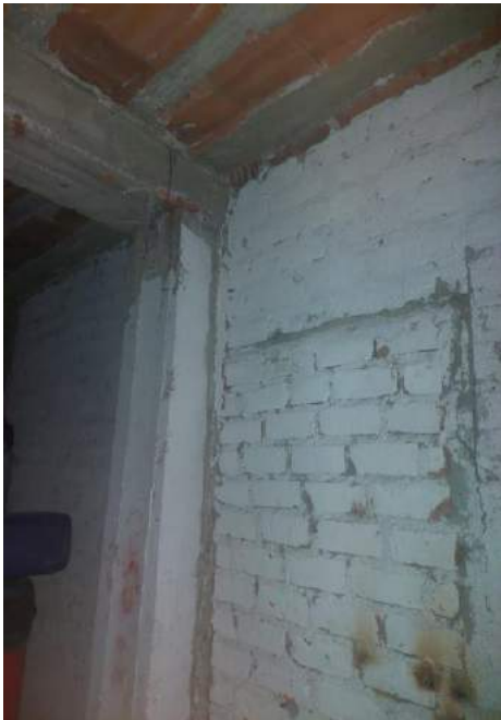
FOTO N° 31 y 32: Evaluación de fallas de la vivienda ubicada en Jr. Brasil Mz. M Lt. 27
