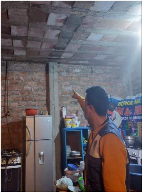
FOTO N° 27: Evaluación de fallas de la vivienda ubicada en Psje. César Vallejo Mz. L Lt. 4
