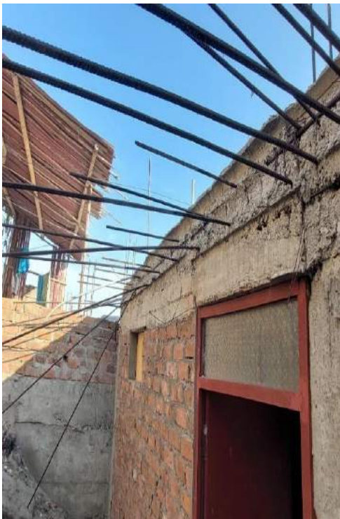
FOTO N° 39: Acero expuesto a corrosión en la vivienda ubicada en Jr. Magallanes Mz. N Lt. 12
