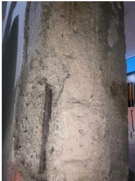
FOTO N° 16 y 17: Fallas de la vivienda Jr. Atahualpa Mz. A Lt. 19, en donde se evidencia corrosión del acero de una de las columnas
