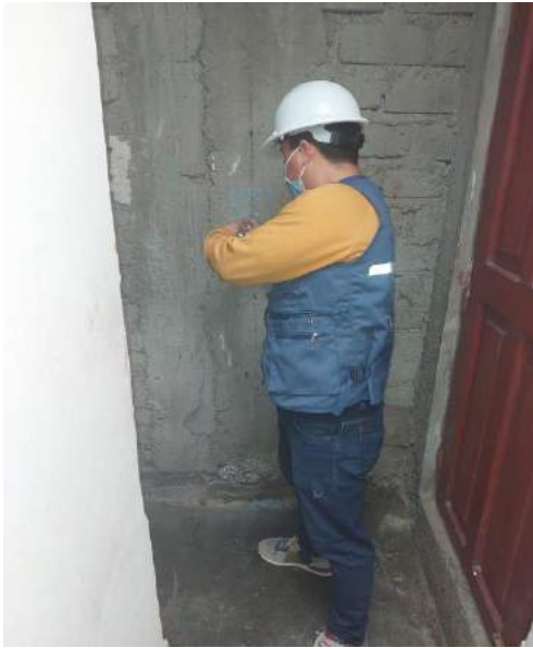
FOTO N° 10: Esclerometría aplicada a la columna de la vivienda 3 en Jr. Los Ángeles Mz. A Lt. 7
