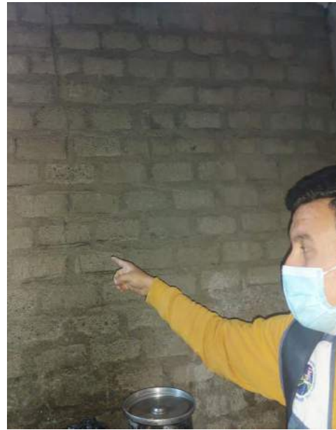
FOTO N° 29: Pequeña fisura en el muro de la vivienda ubicada en Jr. Manco Cápac Mz. M Lt. 13
