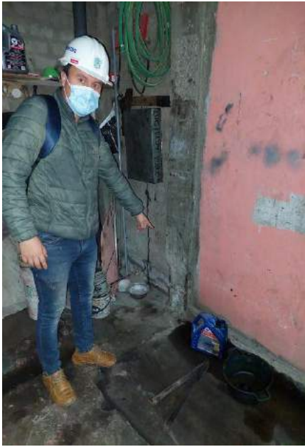
FOTO N° 13: Fallas de la vivienda Jr. Los Ángeles Mz. A Lt. 7, en donde se evidencia daños en una de las columnas
