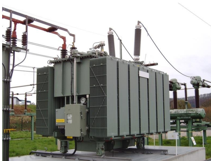
Figura 10. Transformador de potencia. Fuente:
