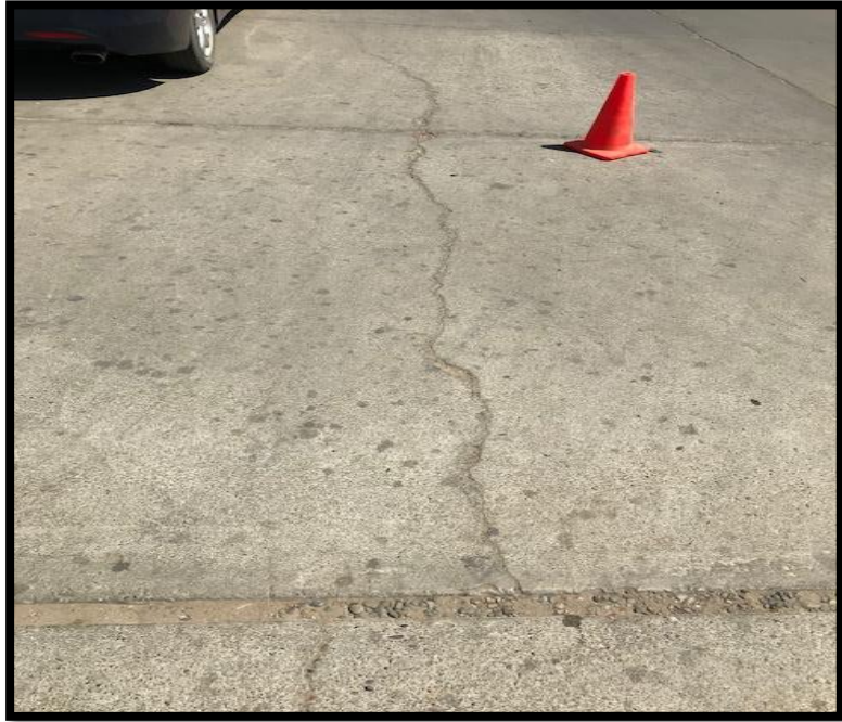
Figura 9: Visualizando las fallas del pavimento rígido
