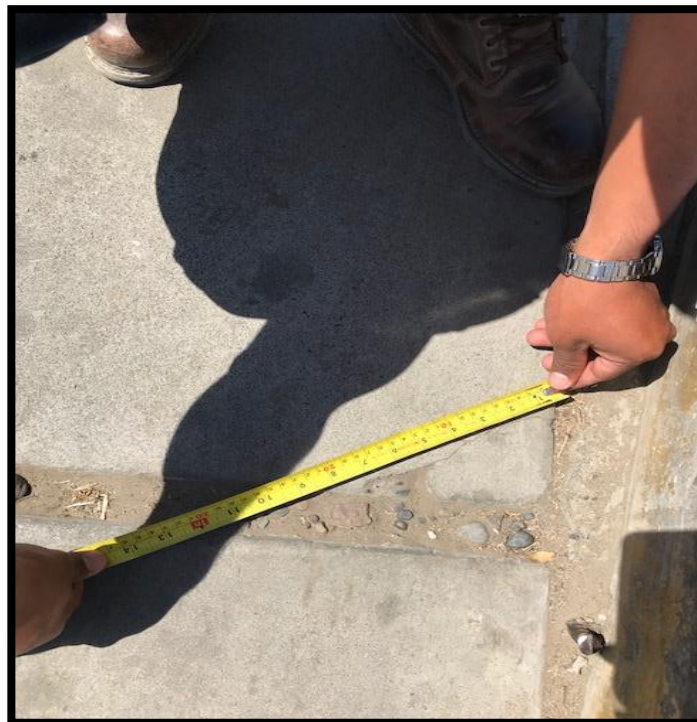
Figura 12: Midiendo las grietas dela esquina del pavimento.
