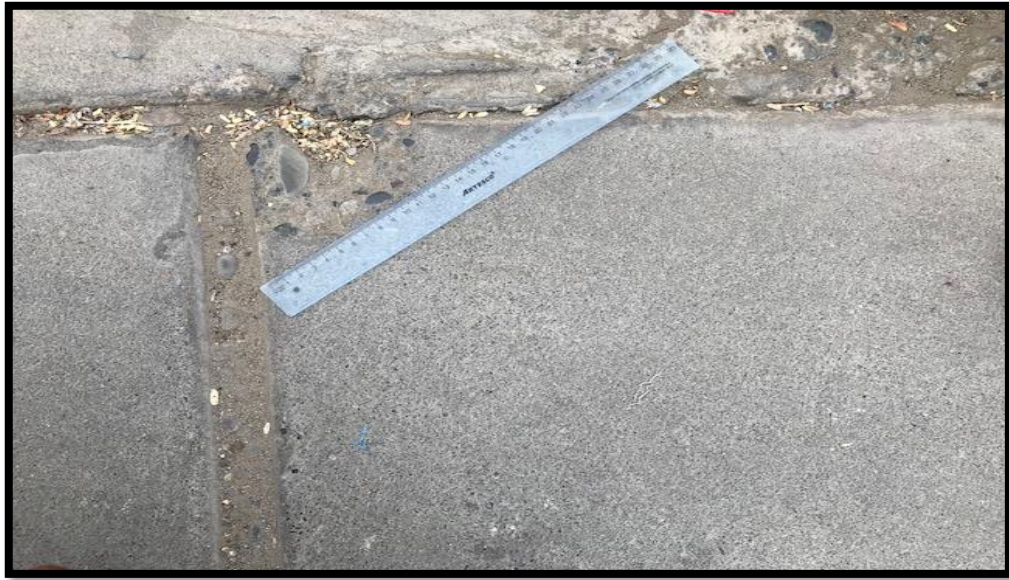
Figura 17: Visualizando que la junta de la parte superior no cumple con las medidas.
