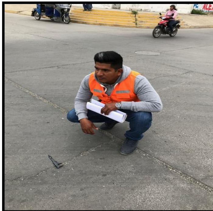
Figura 16: Otra vista de otra grieta del pavimento.
