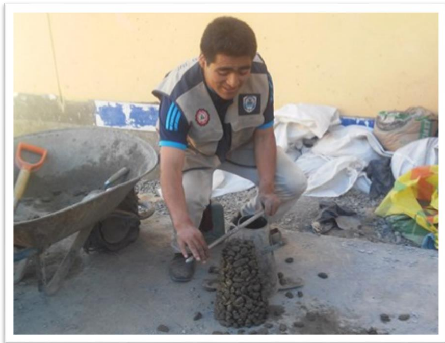
Imagen. 06 Se observa el cono de Abrams para determinar la relación agua cemento del concreto fresco.
