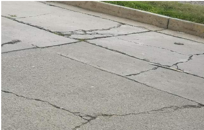
Figura 22 falla de la cuadra 3 Fuente: Autor del proyecto
