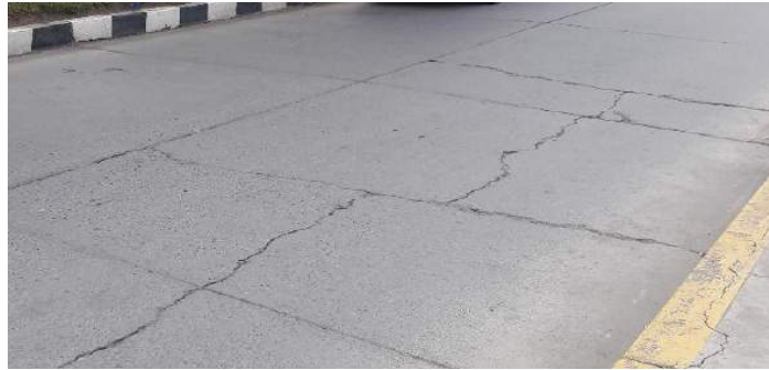
Figura 15 falla de la cuadra 1 Fuente: Autor del proyecto
