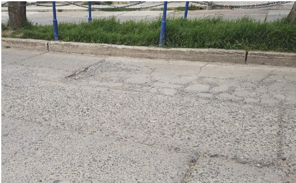
Figura 26 falla de la cuadra 5 Fuente: Autor del proyecto
