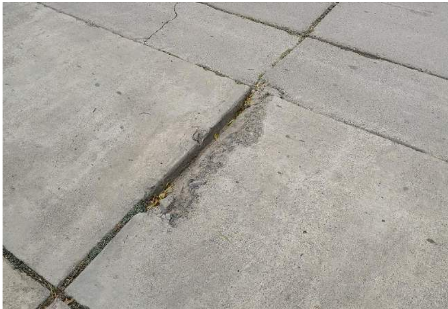
Figura 23 falla de la cuadra 4 Fuente: Autor del proyecto
