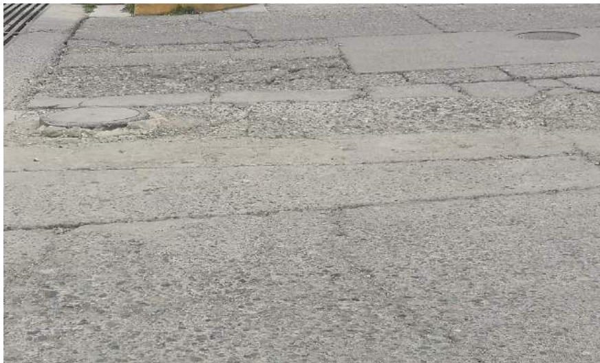
Figura 20 falla de la cuadra 3 Fuente: Autor del proyecto
