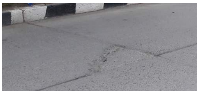
Figura 14 falla de la cuadra 1
