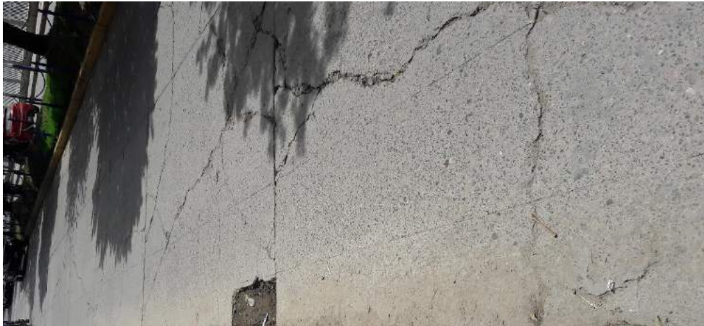
Figura 20 falla de la cuadra 2 Fuente: Autor del proyecto
