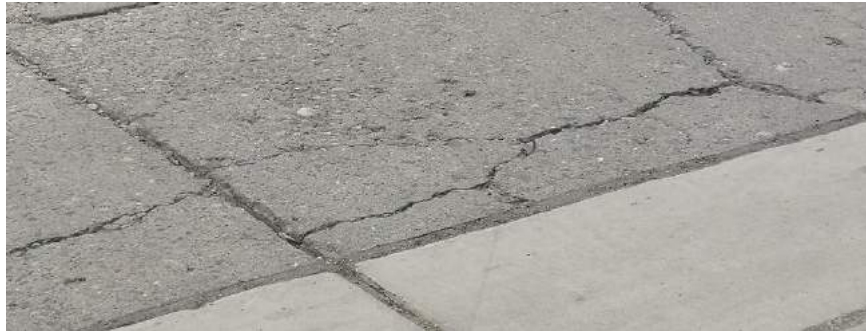
Figura 24 falla de la cuadra 4 Fuente: Autor del proyecto
