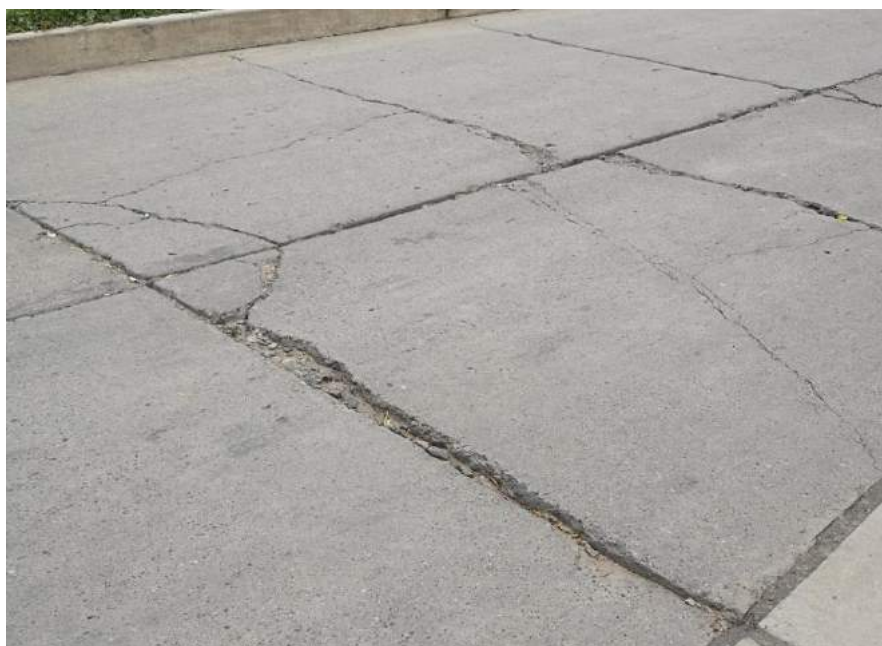
Figura 27 falla de la cuadra 5 Fuente: Autor del proyecto
