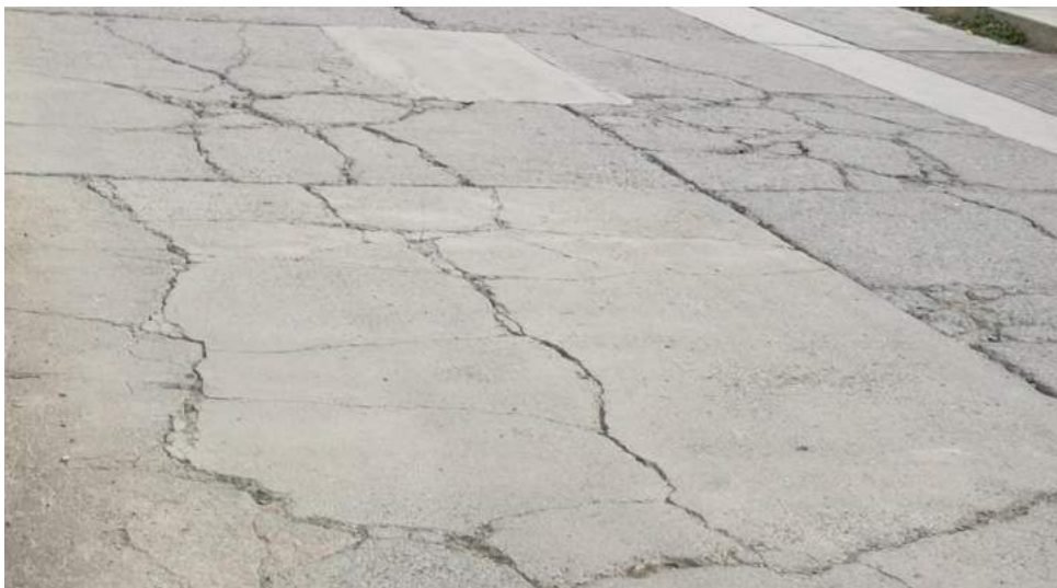
Figura 19 falla de la cuadra 2 Fuente: Autor del proyecto
