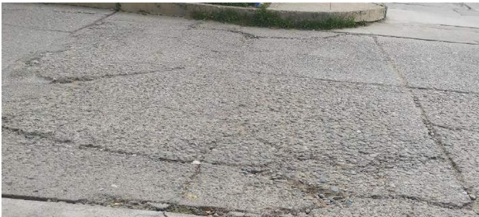
Figura 18 falla de la cuadra 2 Fuente: Autor del proyecto
