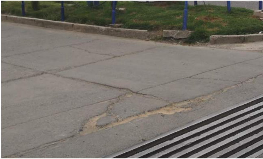
Figura 21 falla de la cuadra 3 Fuente: Autor del proyecto
