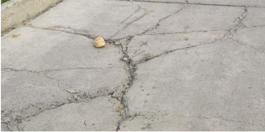
Figura 25 falla de la cuadra 5 Fuente: Autor del proyecto
