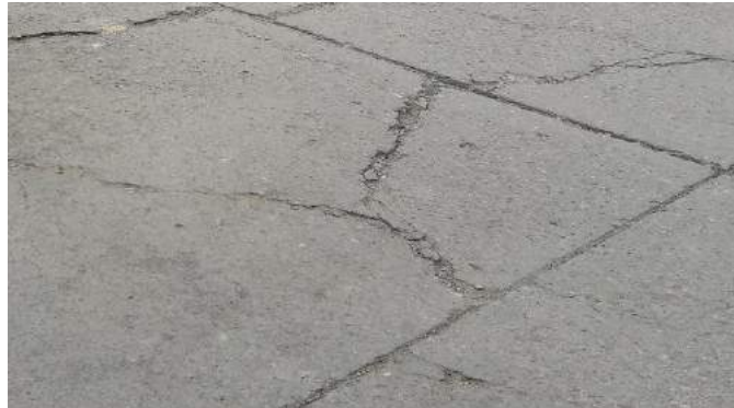
Figura 2 fisura de esquina
