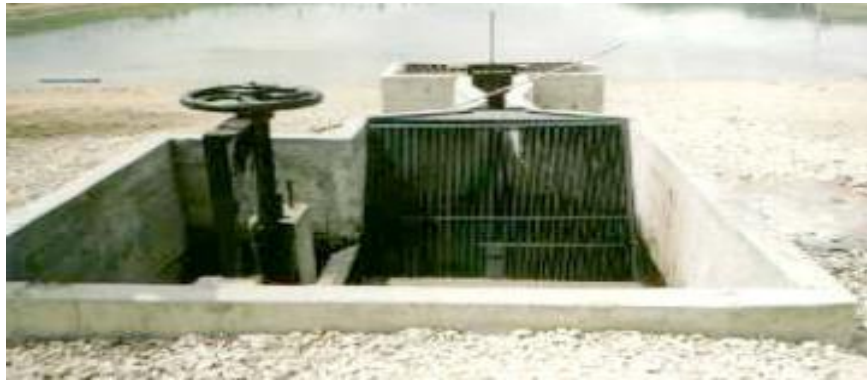
Figura 3: cámara de rejillas
