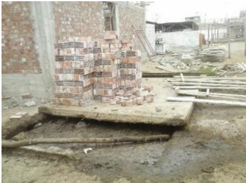
Tercera posa de sedimentacion
