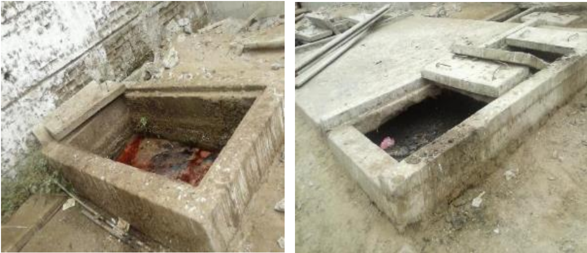
Posas de sedimentacion con las que cuenta actualmente el camal municipal de chimbote
