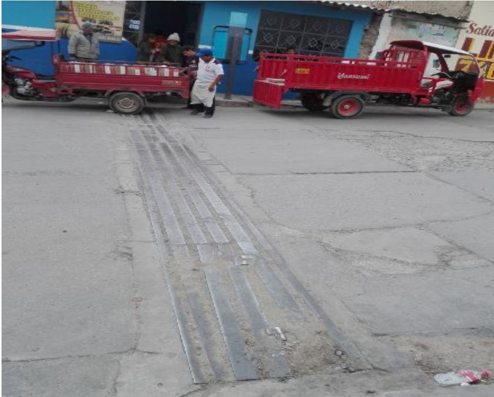
Figura 18. Alcantarilla colmatada de sedimentos y residuos solidos
