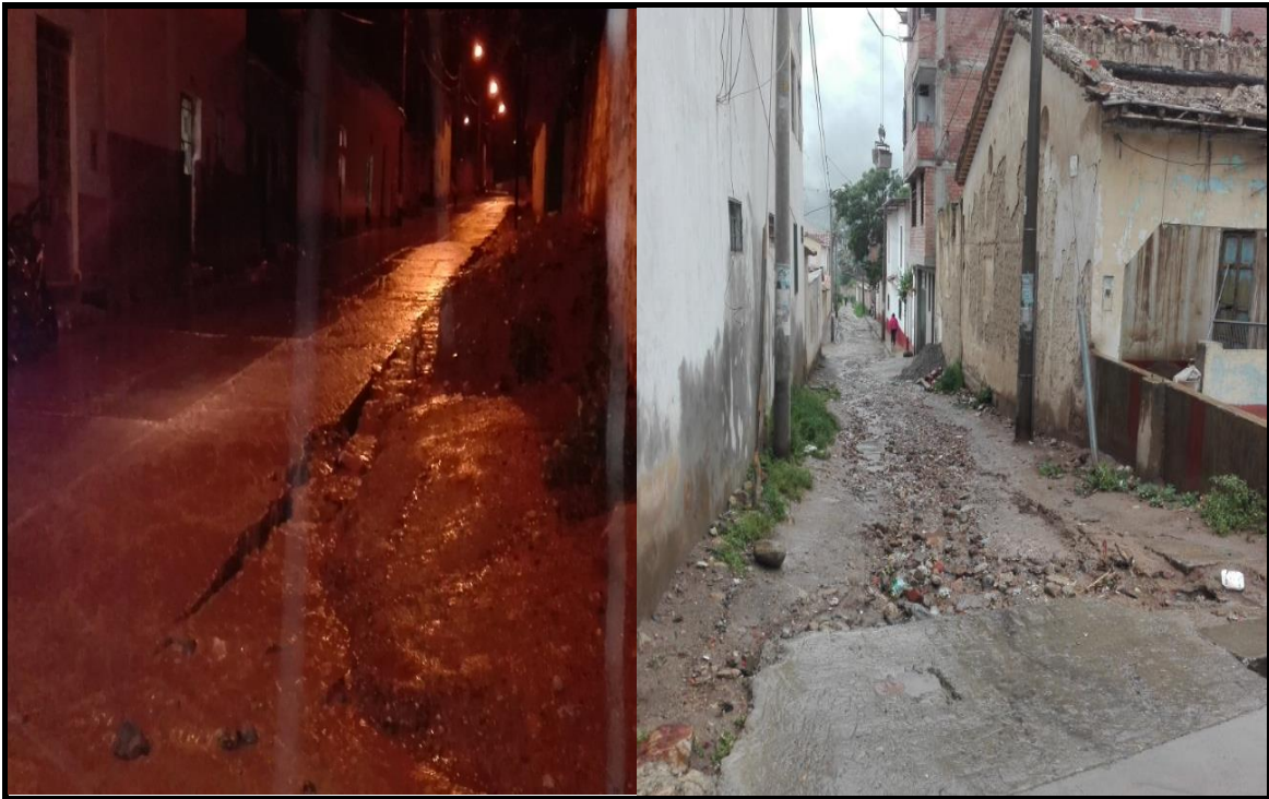
Foto 17-18: Caudal de aguas de lluvia socavan pistas y calles, principalmente calles de las partes bajas. Nota: Tomado en Enero del 2019.
