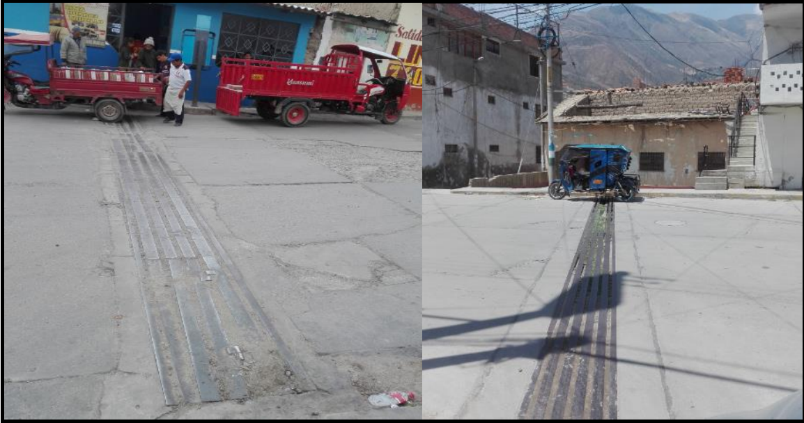
Foto 9-10: Sumideros colmatados con sedimentos y basura, su funcionamiento es nulo por falta de mantenimiento, diferentes puntos, intersección de la Av. Daniel Villar y Jr. Córdova Nota: tomado en Diciembre del 2018.
