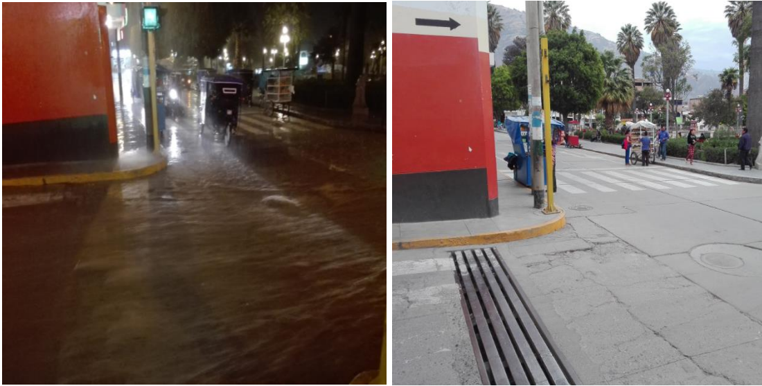
Figura 14. Caudal de aguas de lluvia pasa sobre el sumidero Nota: foto tomada en Marzo del (2018) intersección del Jr. San Martin y plaza de armas
