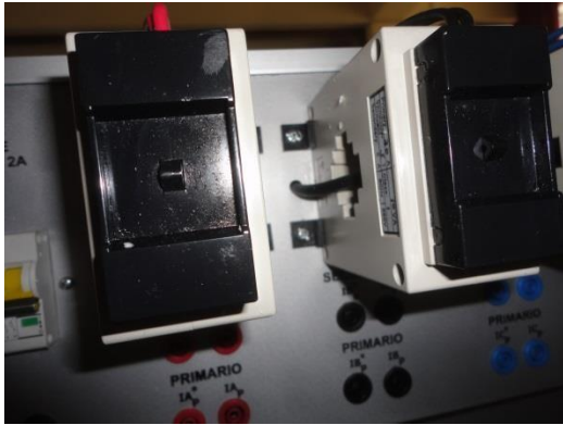
Foto 5.- Transformadores de corriente
