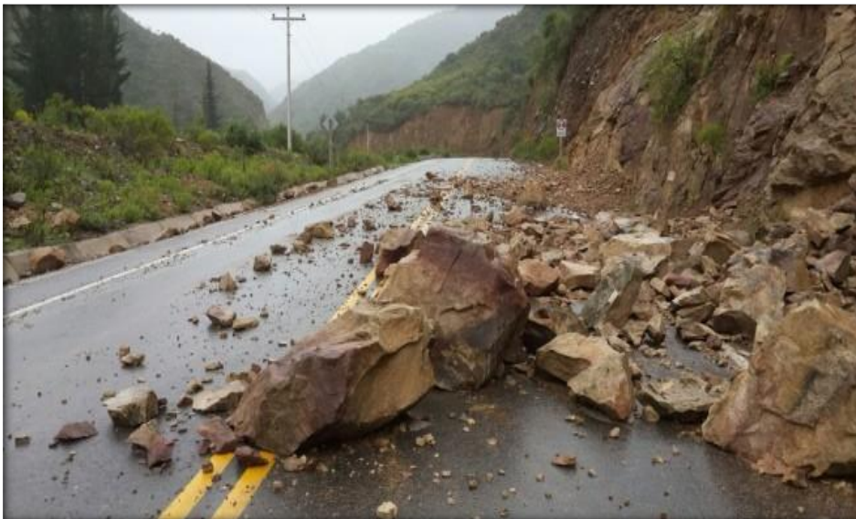
Figura 07: Derrumbes y caída de bloques
