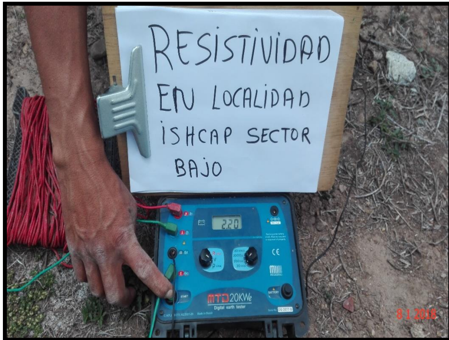
FIGURA N° 11. Resultado de prueba de resistividad en la localidad Ishcap Sector Bajo, a distancia de 4m
