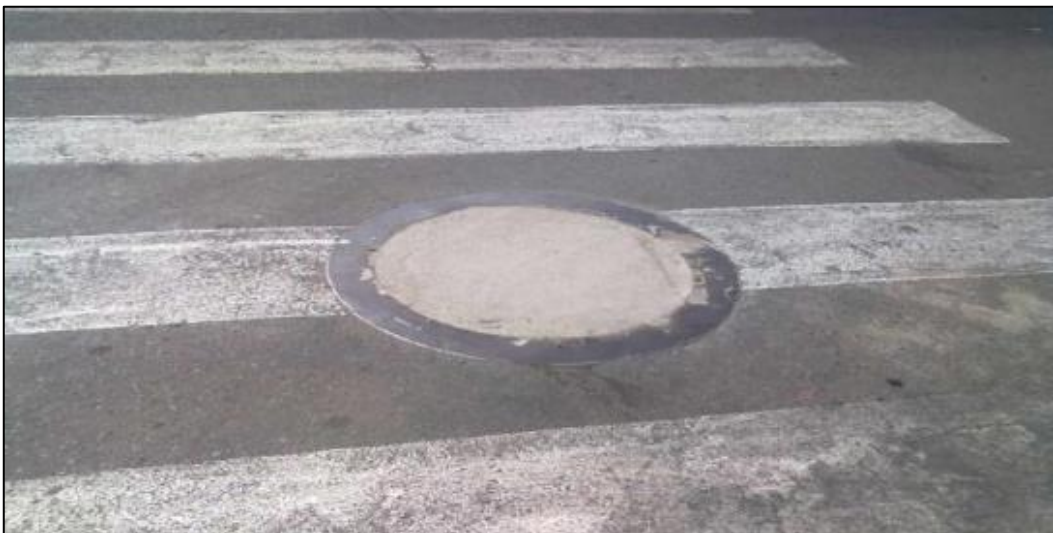
Figura 8. servicio de alcantarilla - desagüe.
